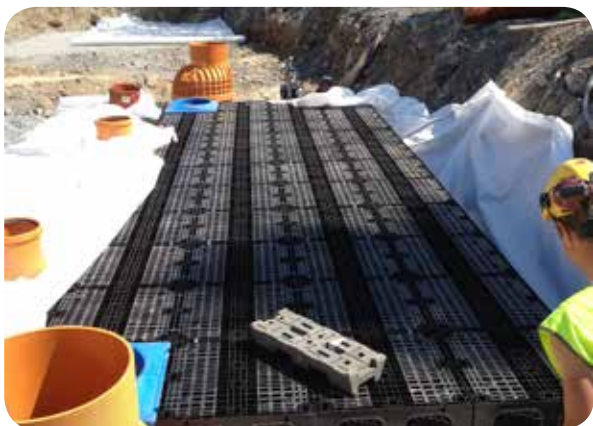
Fördröjningsmagasin under mark i betong och i plast.
